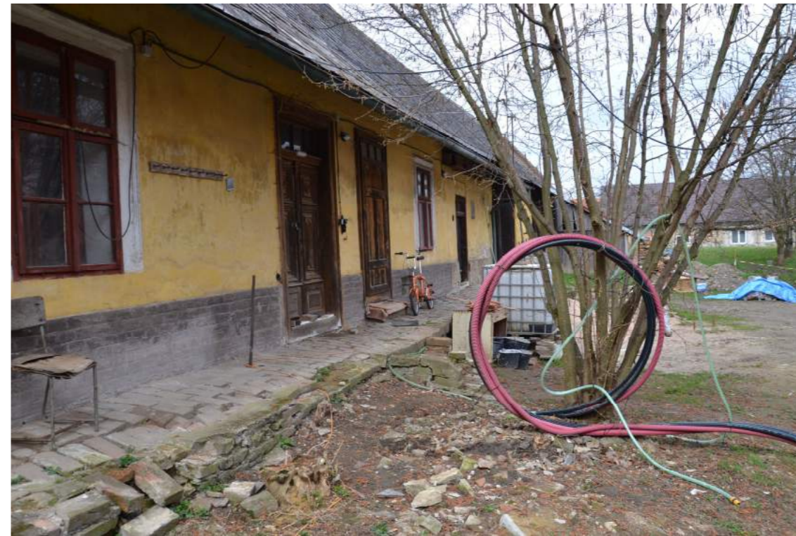
Obr. 29 Budova výminku s hroutícím se cihlovým zápražím při pohledu z dvora.
