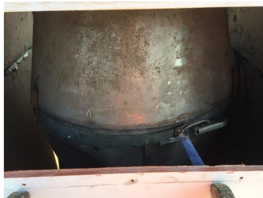
Obr. 57 Upnutí nerezového koše na kužel, vedoucí do plastové roury (Fryč David)
