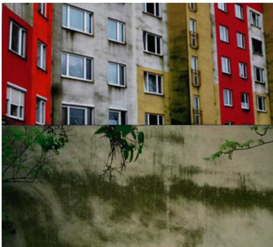
Obrázek č. 9: Příklad moderní fasády napadené řasami a plísní (Zdroj: interní dokument firmy)
