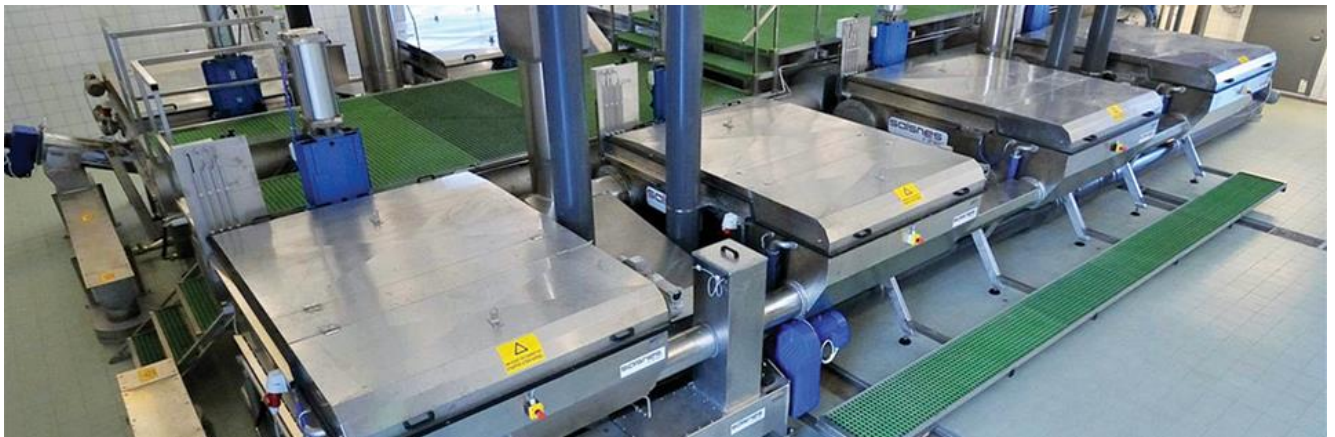
Obr. 5 Osm SFK600 Salsnes filtrů na předúpravě 1,650 \text{ m}^3 \cdot \text{h}^{-1} OV na ČOV, Tomasjord v Norsku (Salsnes Filter-Municipal Installations, n.d.)
