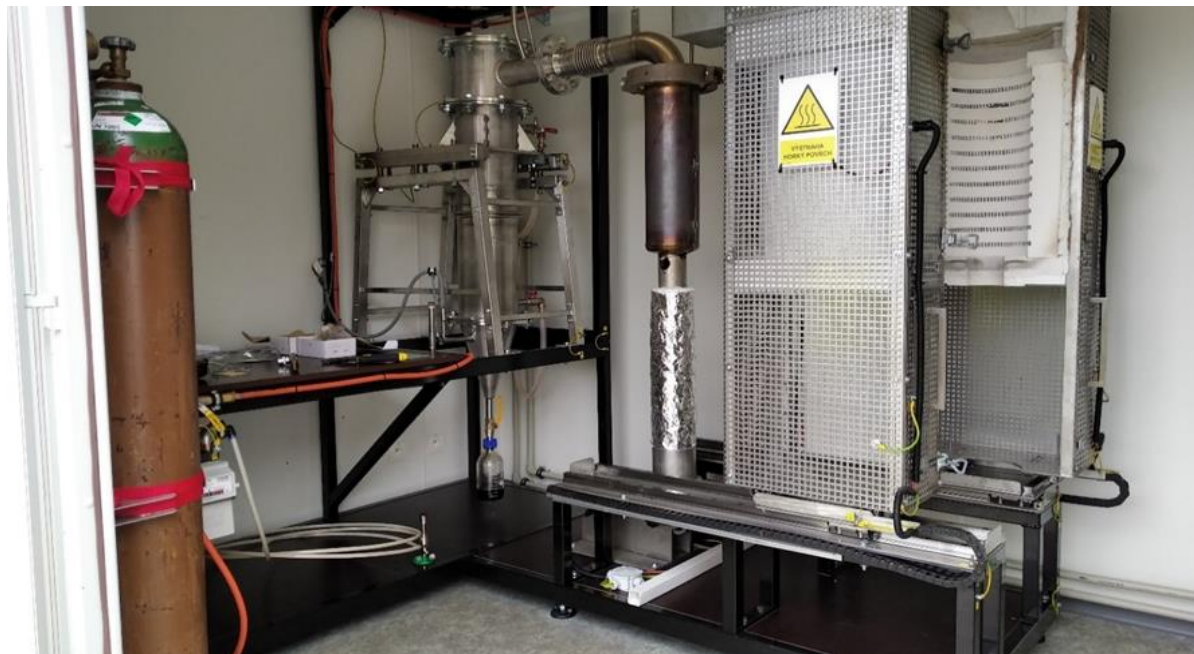
Obr. 43 Instalace a provoz STP jednotky s maximální kapacitou 3 kg-pokus -1 v AdMaS
