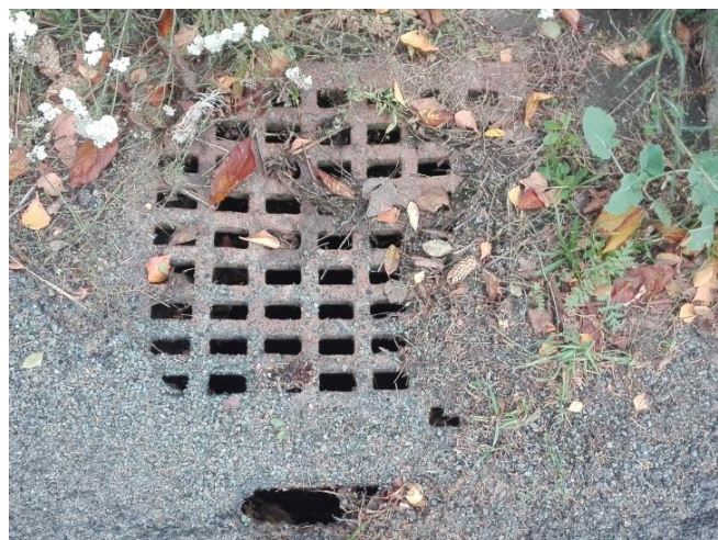
Obrázek 6-10 Stávající šachta ŠP v obci Pačlavice
