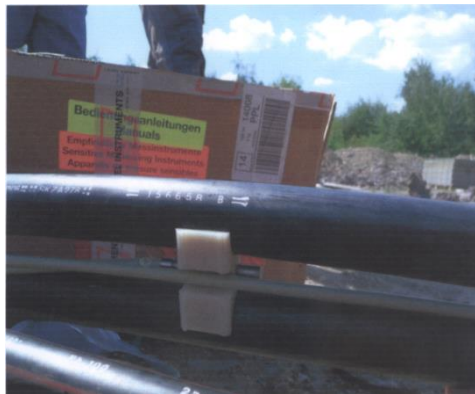
Obr. 20 Způsob umístění čidel mezi jednotlivé větve HDPE potrubí
