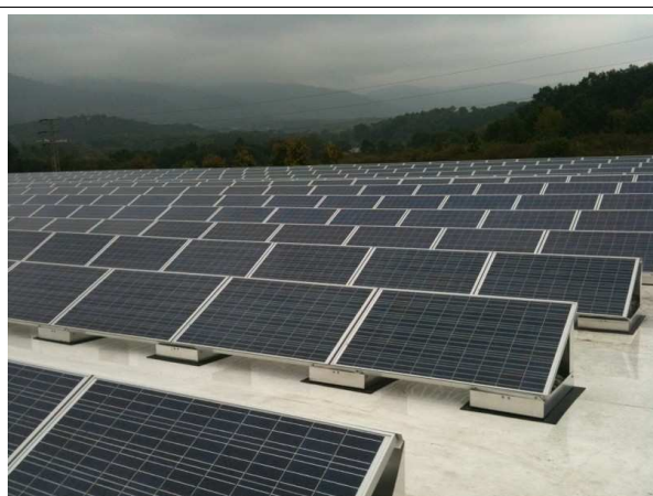
Jižní pohled na hotovou instalaci
