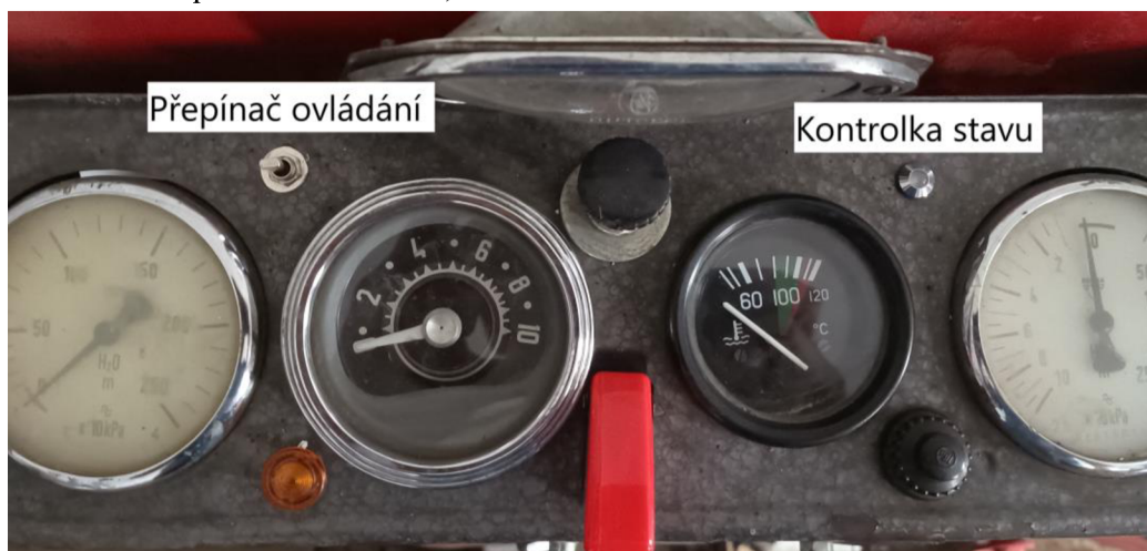
Obrázek 7.10 Umístění kontrolky indikace stavu systému a přepínače ovládní systému na přístrojové desce požární stříkačky PS-12
