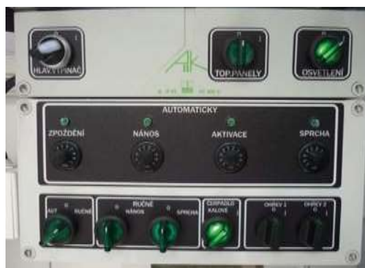
Obr. 19 Ovládací elektrický panel
