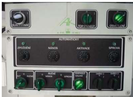
Obr. 19 Ovládací elektrický panel
