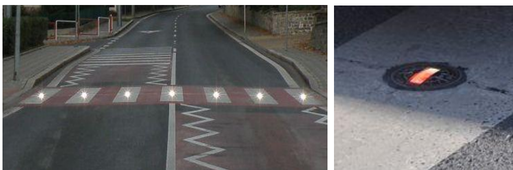
Obr. 14 Přechod s LED technologií a zapuštěné LED svítidlo
