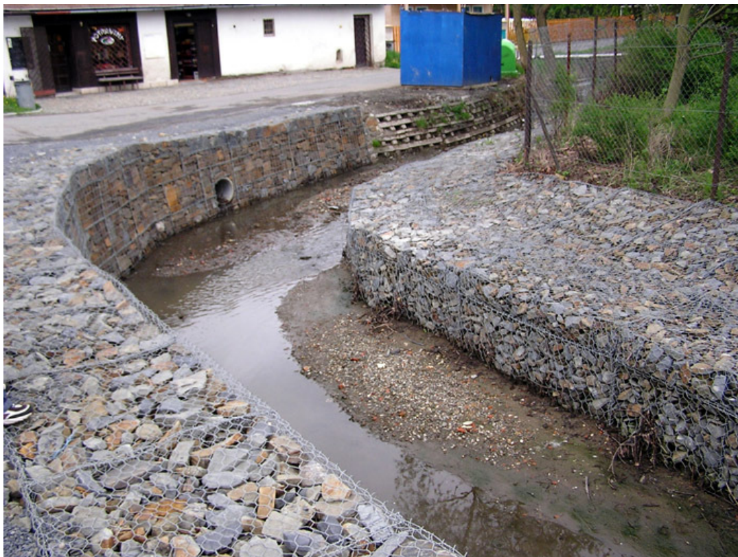
Obr. č. 8.: Ukázka opevnění břehů – drátokamenné matrace. Úprava toku ve Staré Bělé. (Zdroj: hgf10.vsb.cz).
