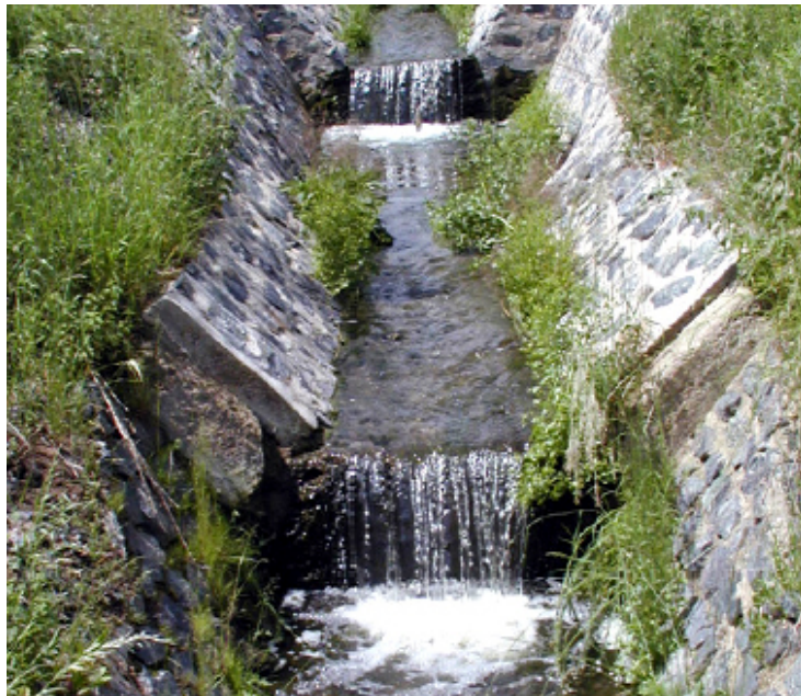
Obr. č. 6.: Ukázka nevhodného revitalizačního zásahu – vytvoření migračních bariér (Vrána a kol., 2004).
