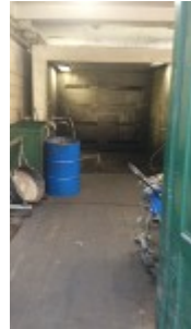
Foto č. 4: Umývárna strojních součástí
