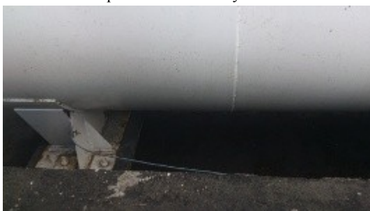
Foto č. 24: Čerpací stanice – záchytná vana
