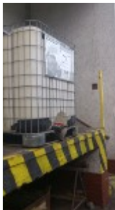
Foto č. 16: Nádrž na moto- rový olej
