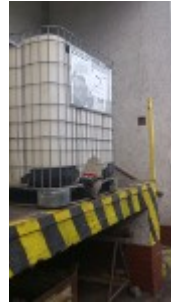
Foto č. 2: Nádrž na motorový olej – sklad
