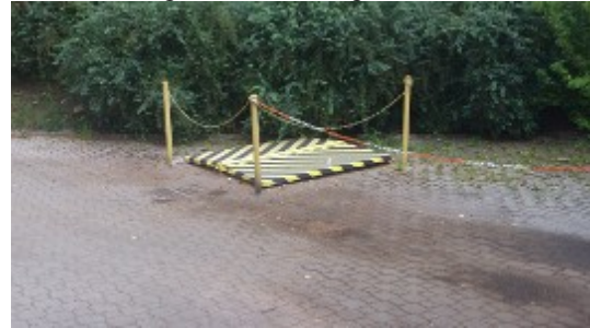
Foto č. 6: Čerpací stanice – lapol
