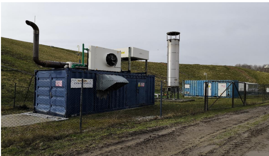
Obr. 6: Kogenerační jednotka a vysokoteplotní pochodeň skládky Tisová (fotoarchiv autora, 2019)
