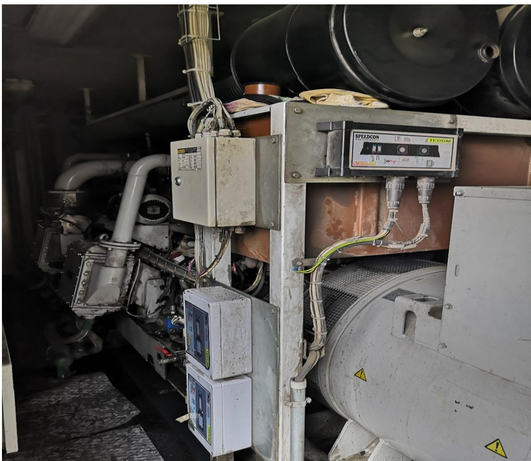
Obr. 7: Vnitřek kogenerační jednotky – plynové motory (fotoarchiv autora, 2019)
