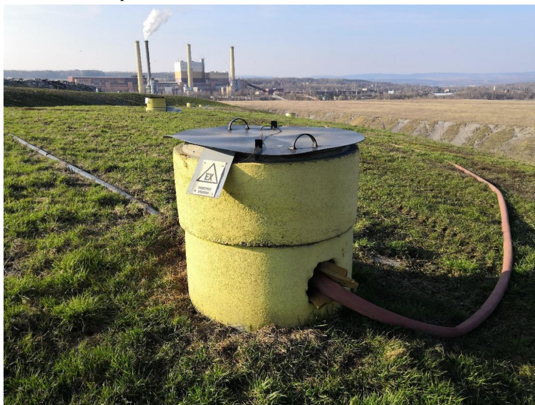
Obr. 4: Plynová studna umístěná na koruně skládkového tělesa (fotoarchiv autora, 2019)
