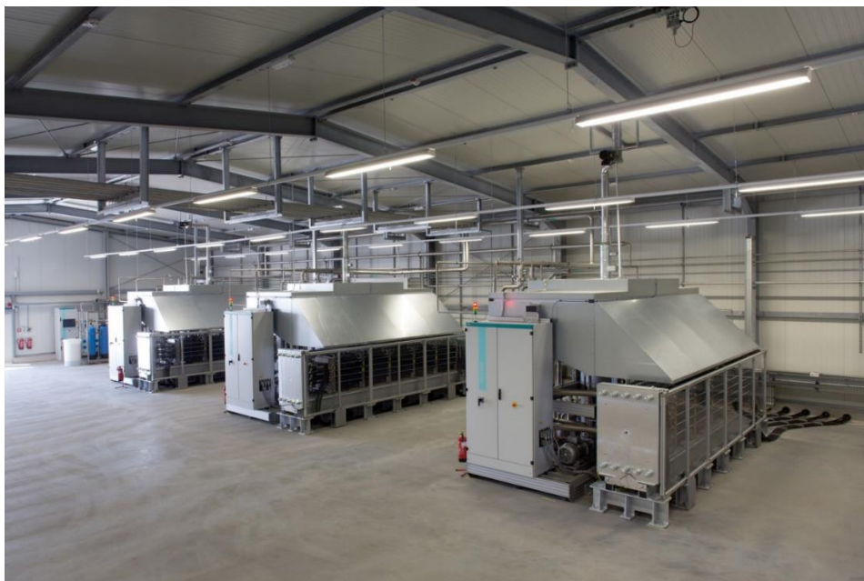
Obrázek 4.2 Elektrolyzéry na výrobu vodíku v hale Energiepark Mainz [51]
