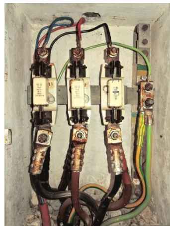
Obrázek 7: Hl. domovní kabelová skříňka (Zdroj: vlastní fotografie)
