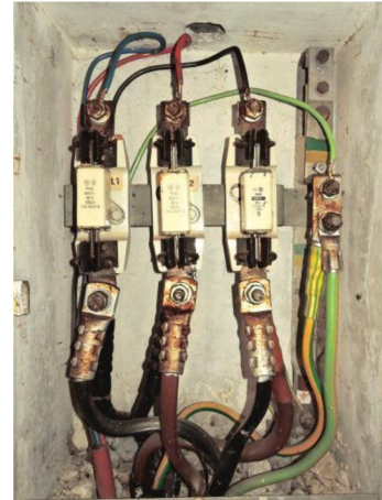
Obrázek 7: Hl. domovní kabelová skříňka (Zdroj: vlastní fotografie)
