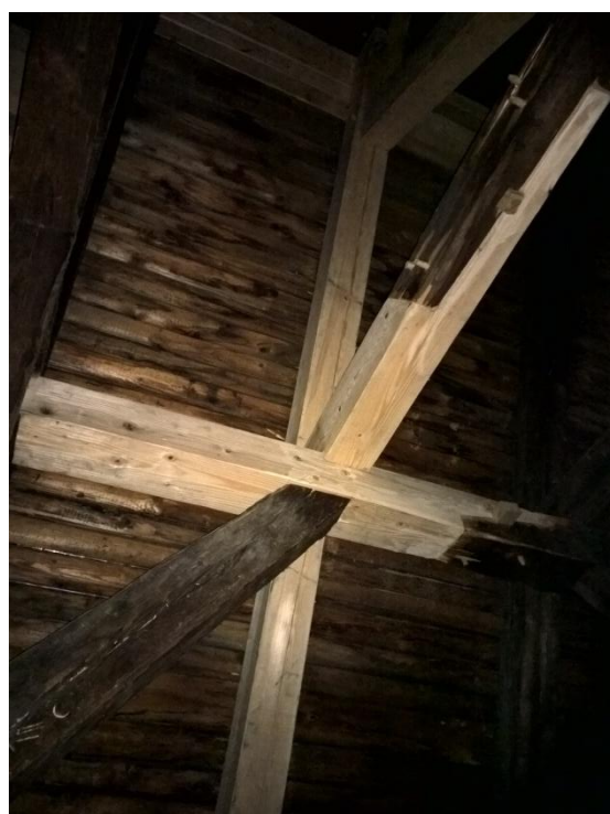
Obr. 51 Výměna krokve s částí mezilehlé vaznice, zhlaví hambalku a krokevní vzpěry. Všude využito pouze celodřevěných spojů. Foto: Bc. Radomír Dvořák
