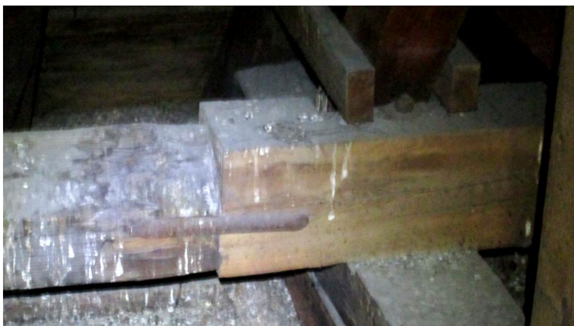
Obr. 49 Opět nevhodné nahrazení pětibokého prahu řezaným hranolem z borovice. Spojení je provedeno na „tupo“, zajištěno pouze párem tesařských kramlí. Foto: Bc. Jakub Hapala
