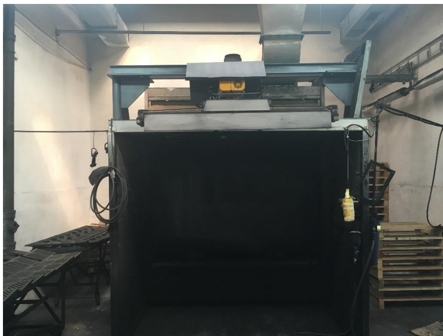
Obr. 2.18 Komora pro nanášení nátěrových hmot.
