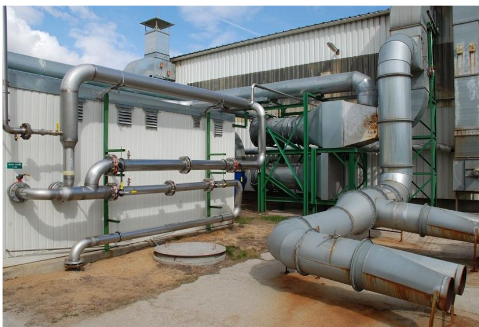
Obr. č. 37: Plynovody přivádějící plyn na kogenerační jednotky (zdroj: Autor).
