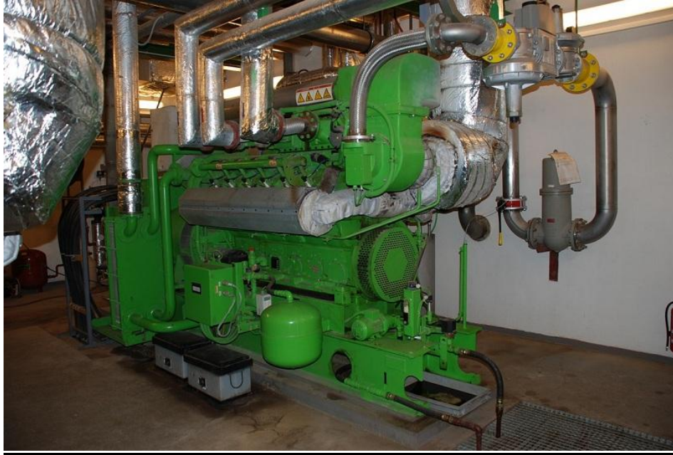
Obr. č. 38: Detail kogenerační jednotky (zdroj: Autor).
