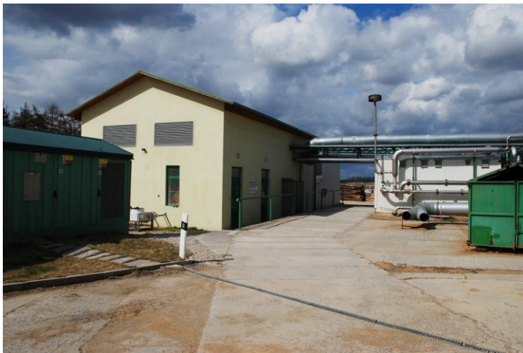
Obr. č. 25: Přívod plynu na kogenerační jednotky na skládce Ekologie (zdroj: Autor).
