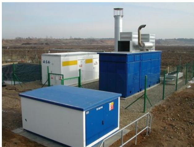
Obr. č. 11: Kogenerační jednotka na skládce Uhy u Kralup nad Vltavou (zdroj: http://www.asa-group.com/cs/Ceska-republika/Technologie/Skladky-1.asa ).
