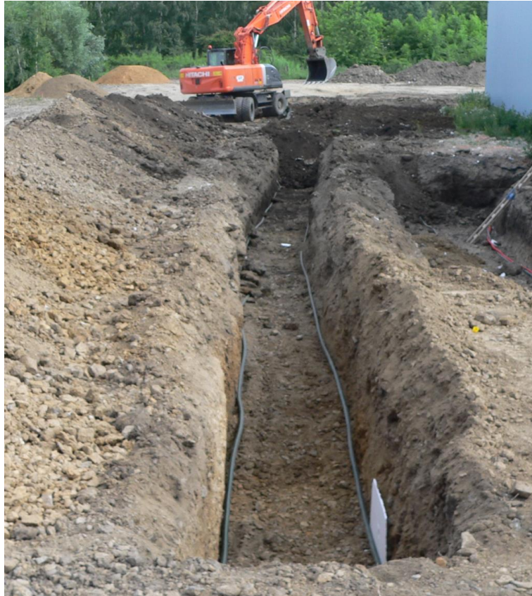
Obr. 6 Uložení lineárního tepelného výměníku (archiv autora)
