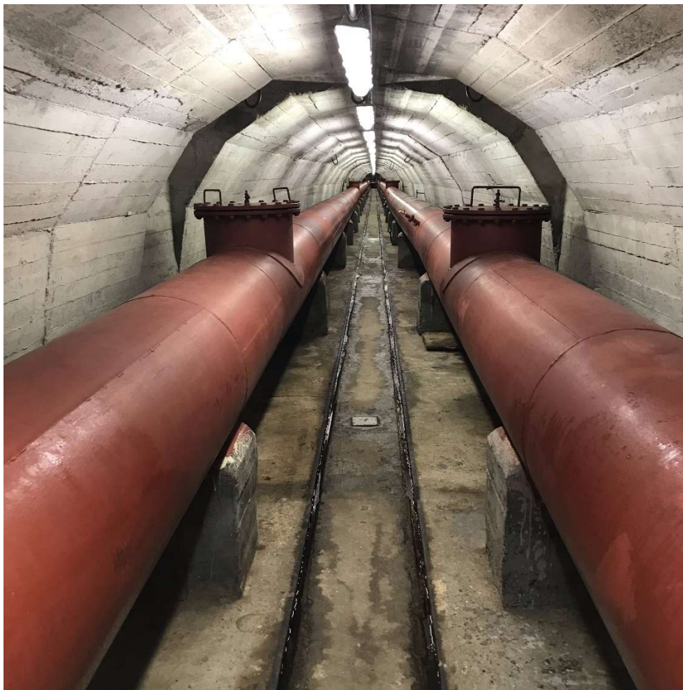
Obr. 2.9 Chodba spodních výpustí s výpustným potrubím
