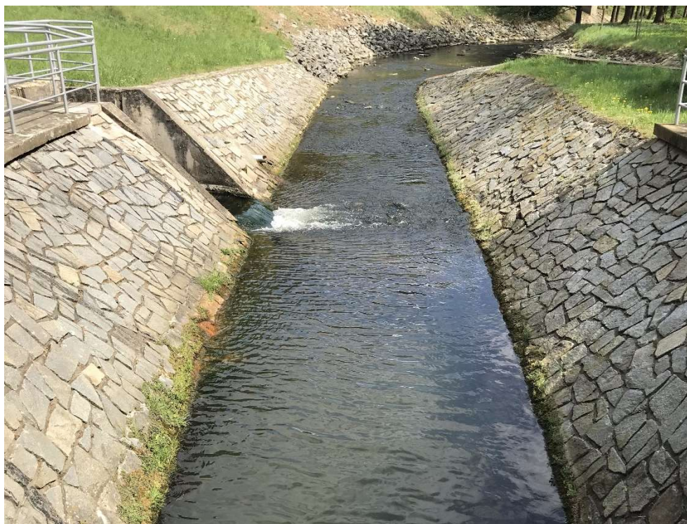
Obr. 2.11 Vývar spodních výpustí
