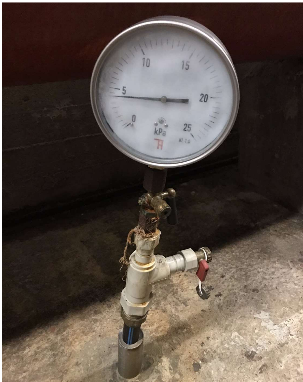
Obr. 2.30 Tlakoměrný vrt V5 s manometrem
