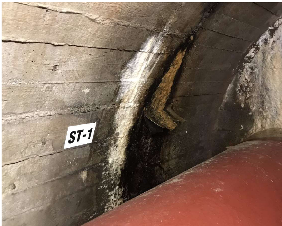
Obr. 2.28 Místo průsaku ST1 dilatační spárou do chodby spodních výpustí
