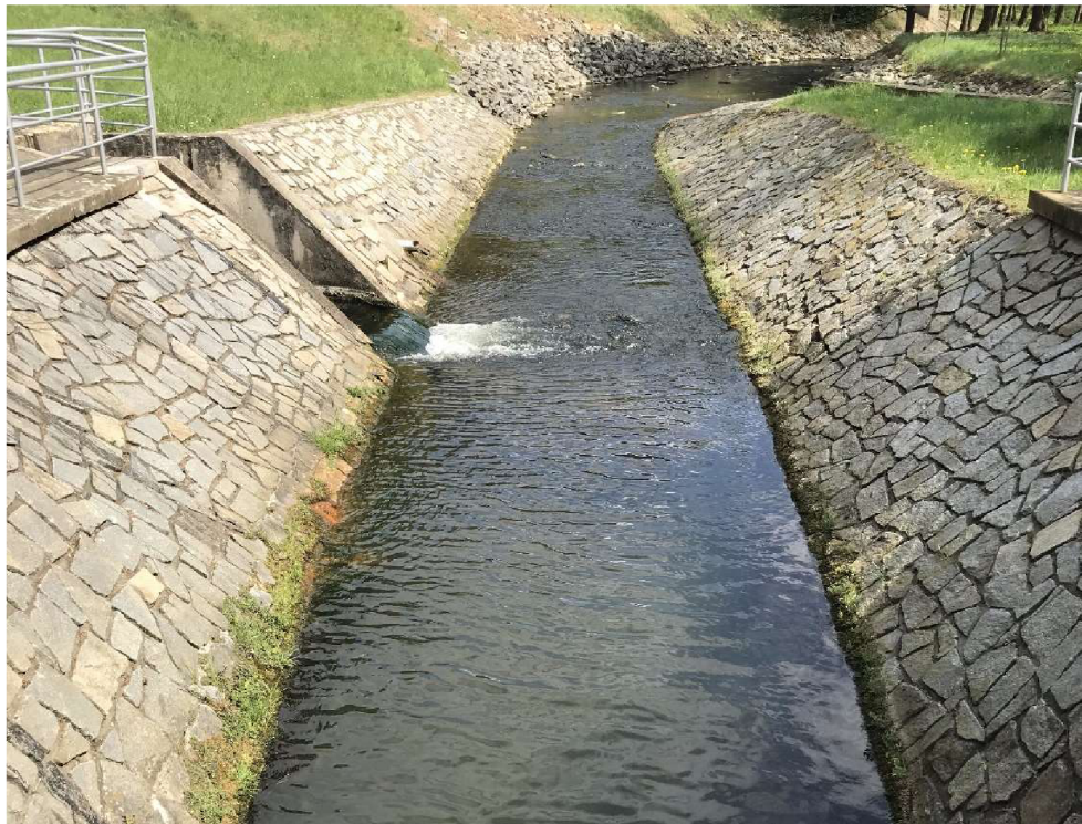
Obr. 2.11 Vývar spodních výpustí
