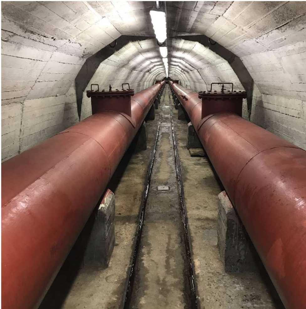
Obr. 2.9 Chodba spodních výpustí s výpustným potrubím
