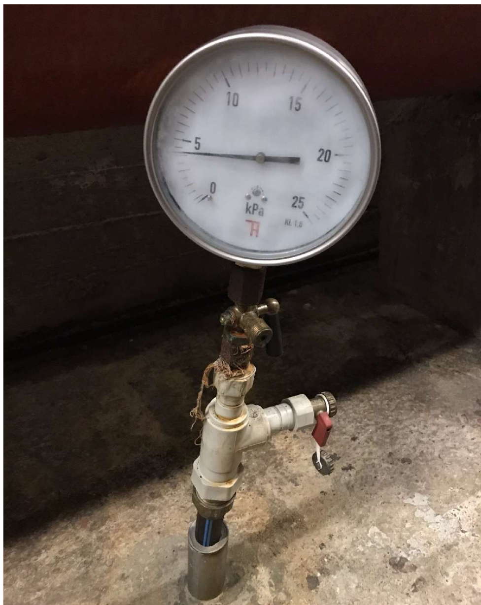
Obr. 2.30 Tlakoměrný vrt V5 s manometrem
