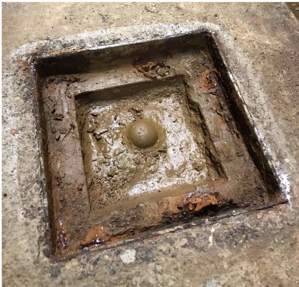
Obr. 2.35 Nivelační bod 12 v chodbě spodních výpustí bez poklopu
