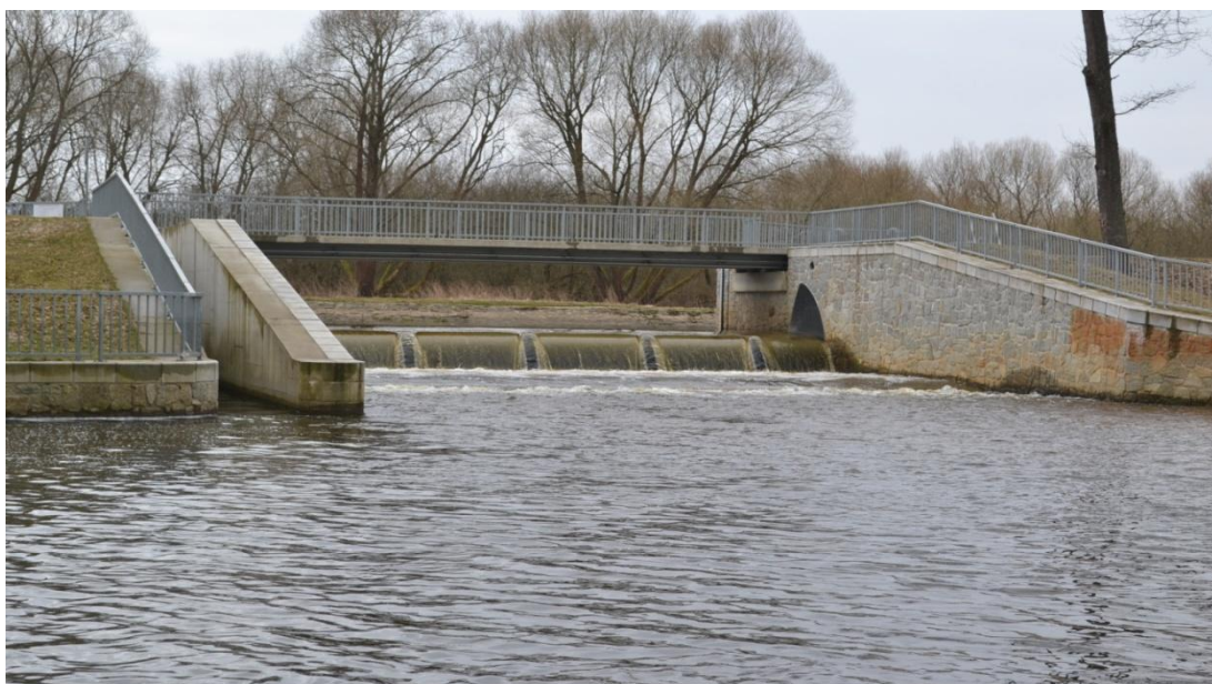
Obrázek 13. – Celkový pohled na Novořecký jez s objektem žlabového rybího přechodu (foto autor)
