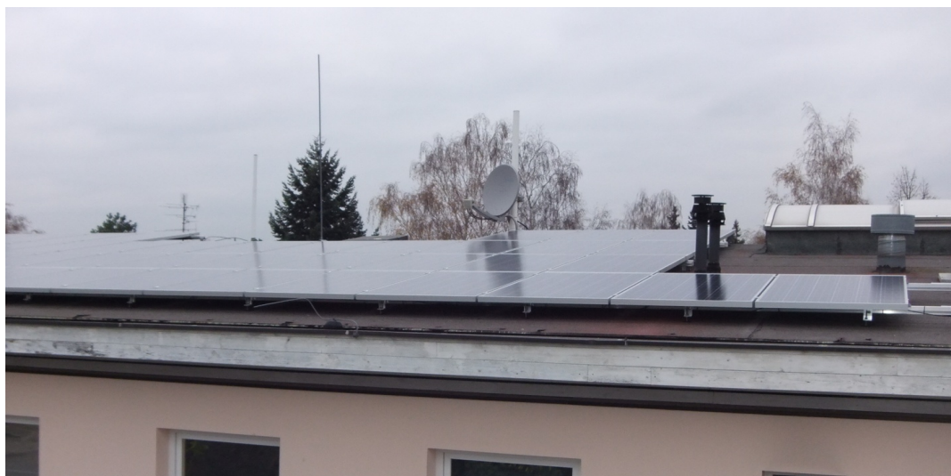
Obrázek 24 - Pohled na jímací soustavu a FVE
