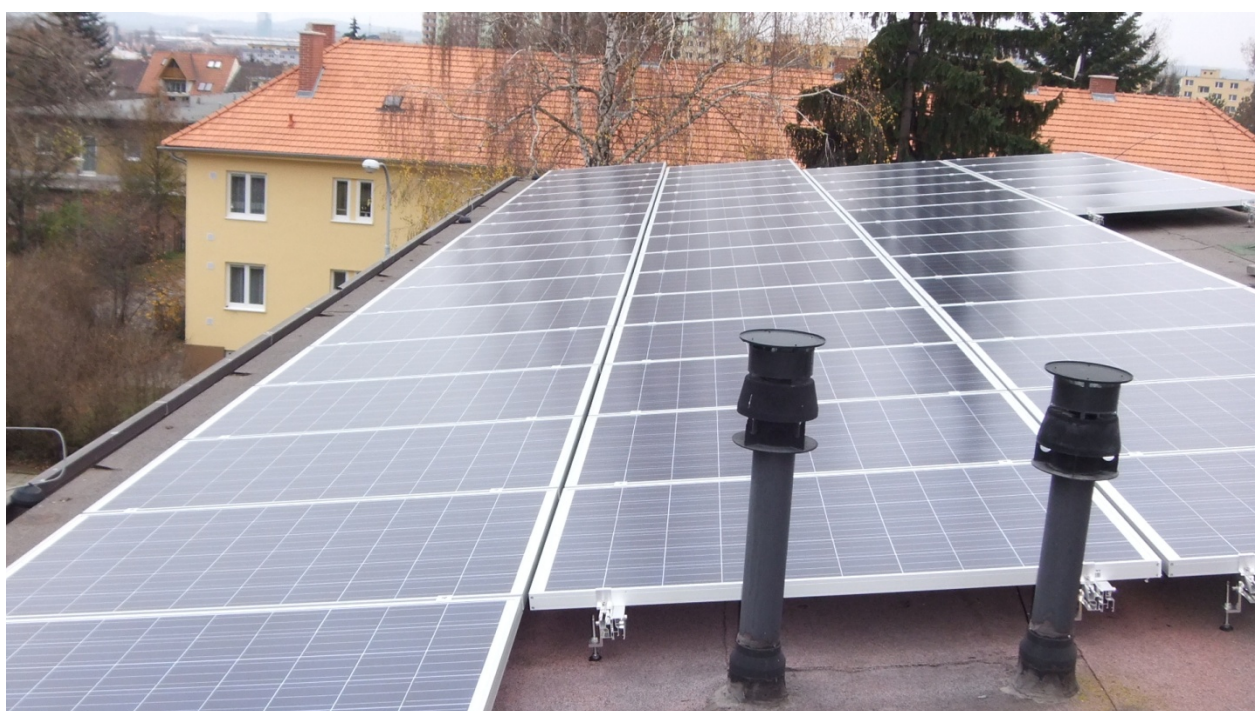
Obrázek 21 - Střešní pohled na FVE
