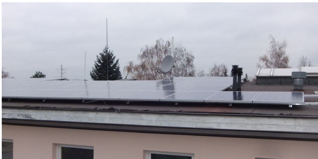
Obrázek 24 - Pohled na jímací soustavu a FVE
