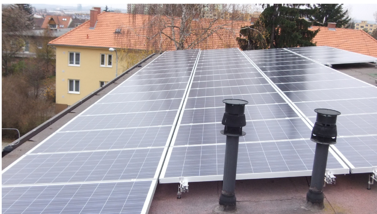
Obrázek 21 - Střešní pohled na FVE
