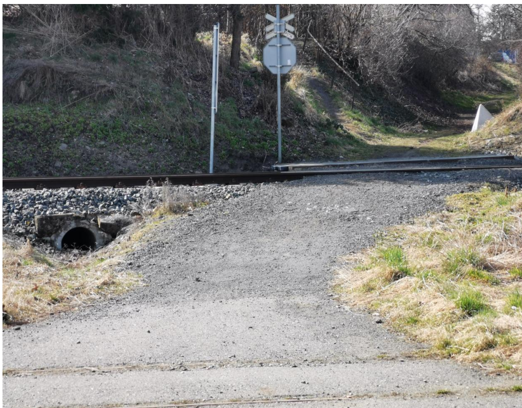
Obrázek č. 47 přejezd k polní cestě vedle p.b. 2605/5, vlevo propustek pod tratí
