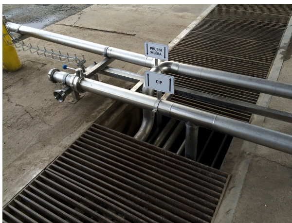
Obr. 10 Příjmové potrubí – příjem mléka
