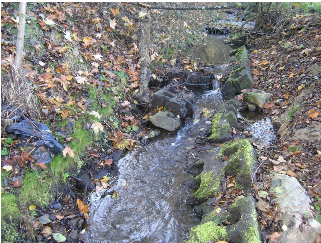
Polorozpadlé opevnění v prvním úseku (zdroj: vlastní)
