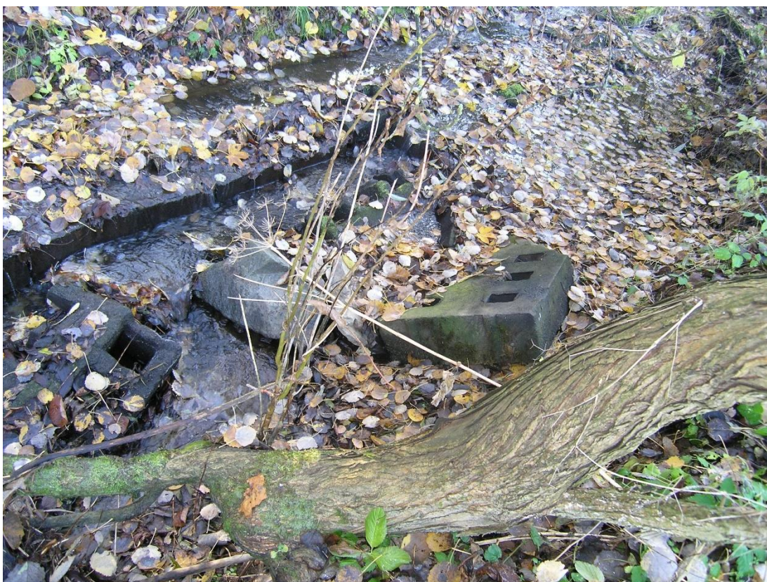
Vytrhané polovegetační tvárnice, první úsek (zdroj: vlastní)
