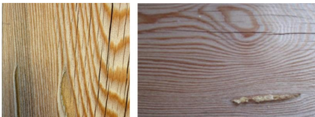
a) Poškození prasklinami
