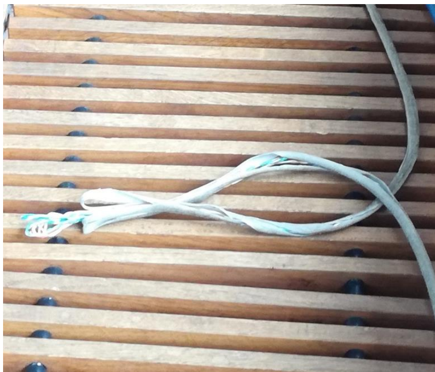
Obrázek 5: UTP kabel spojující switch kanceláře 1 s kanceláři 2 (situace prosinec 2019). Zdroj:[vlastní]
