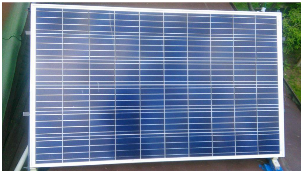
Obrázek 27: fotografie instalovaného modulu
