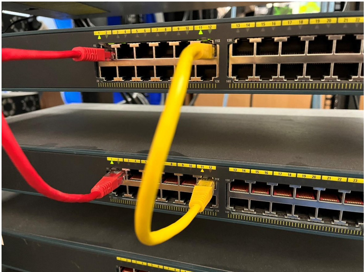
Obrázek 36: Přerušení smyčky na přepínači Cisco 2960. Zdroj: [vlastní zpracování]
