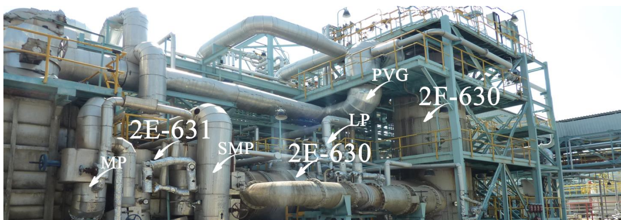
Obr. 30 Spalovací komora 2F-630 a další zařízení spalovny 2U-600
