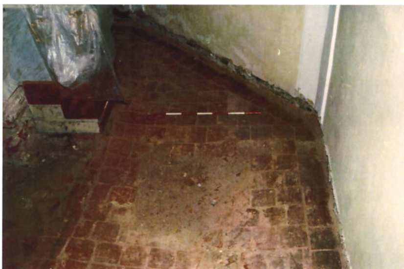
Obr. 88. JZ strana presbytáře. Propadlá dlažba 1/99 od SZ. Foto K. Faltýnek. Č. neg. 105683.
