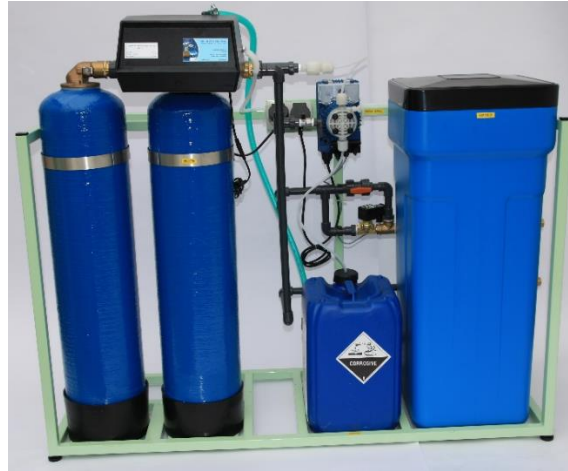
Obr. 20 – Automatická úpravna vody Deto Brno [34]
