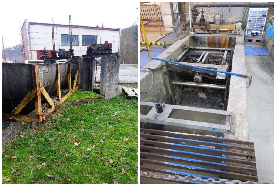
Obrázek 42, 43: Přítok na ČOV, (foto, 2023); Česle v areálu ČOV, (foto, 2023)
