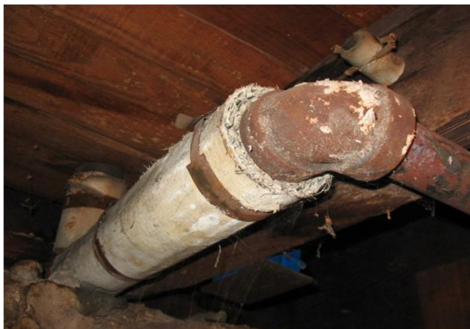
Obrázek 7 - Azbestová izolace potrubí
