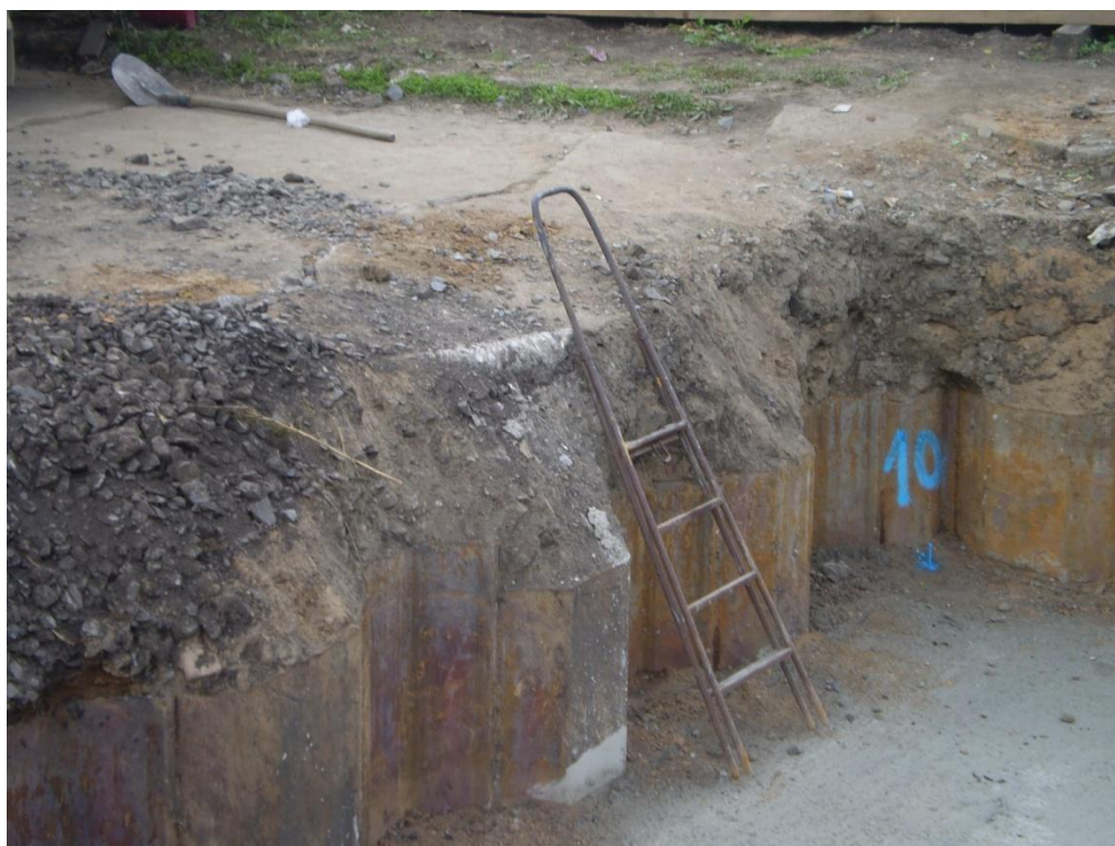
Obr. 32 - Nevhodné použití žebříku 2
