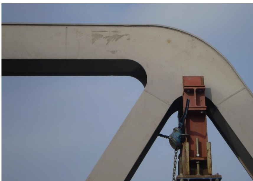
Obr. 24 - Poškození bočnice konstrukce o krajní traverzy
