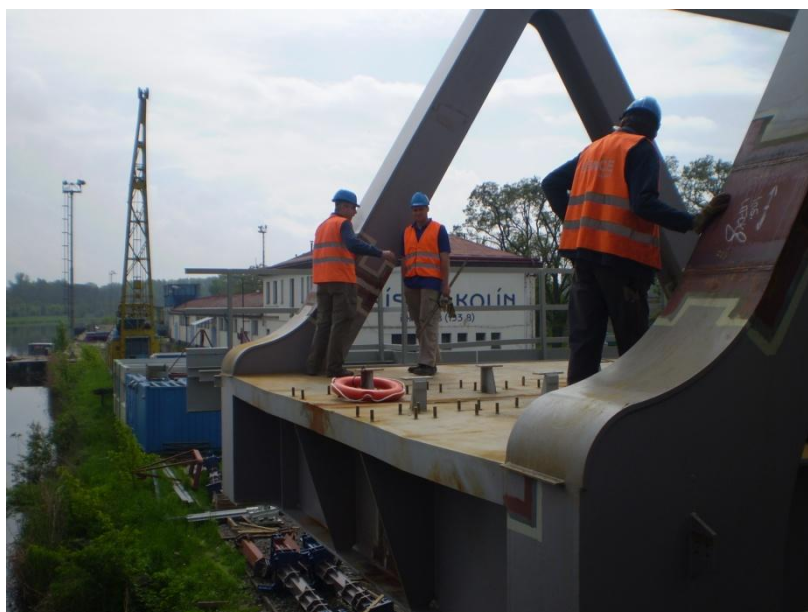
Obr. 15 - Nezabezpečení okraje mostu
