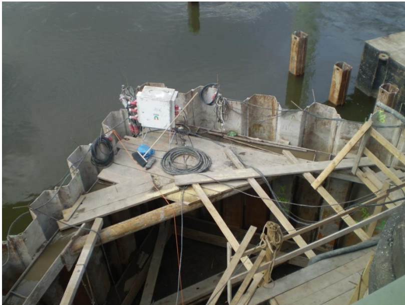
Obr. 4 - Nevhodný rozvod elektrického proudu
