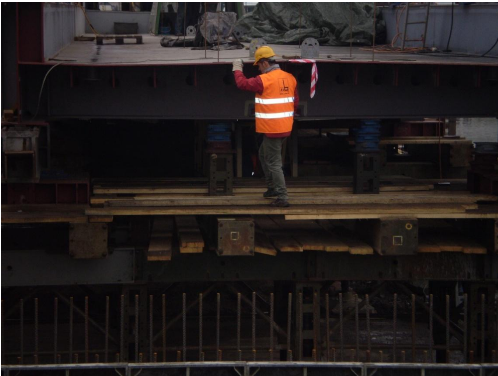
Obr. 28 - Práce ve výšce – Nezabezpečení proti pádu osoby 2
