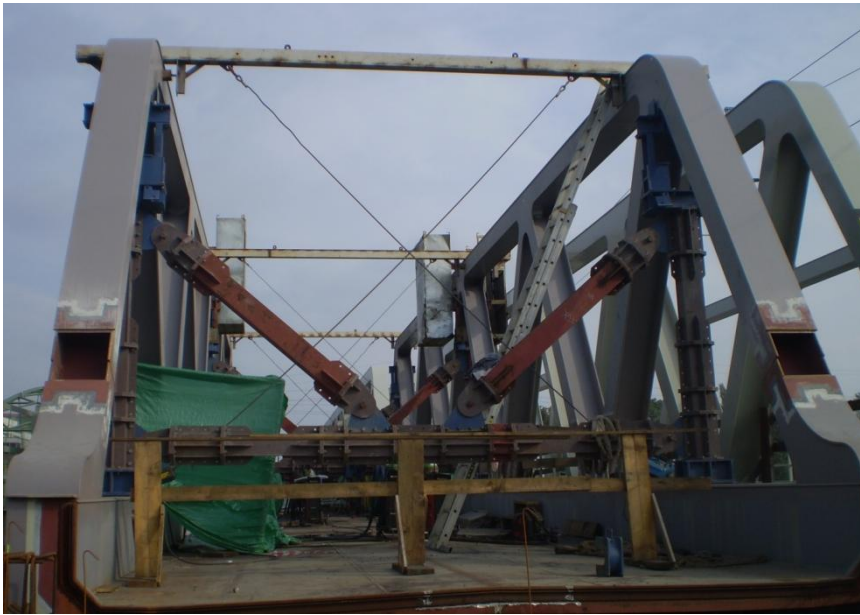
Obr. 18 - Vhodné zabezpečení mostu
