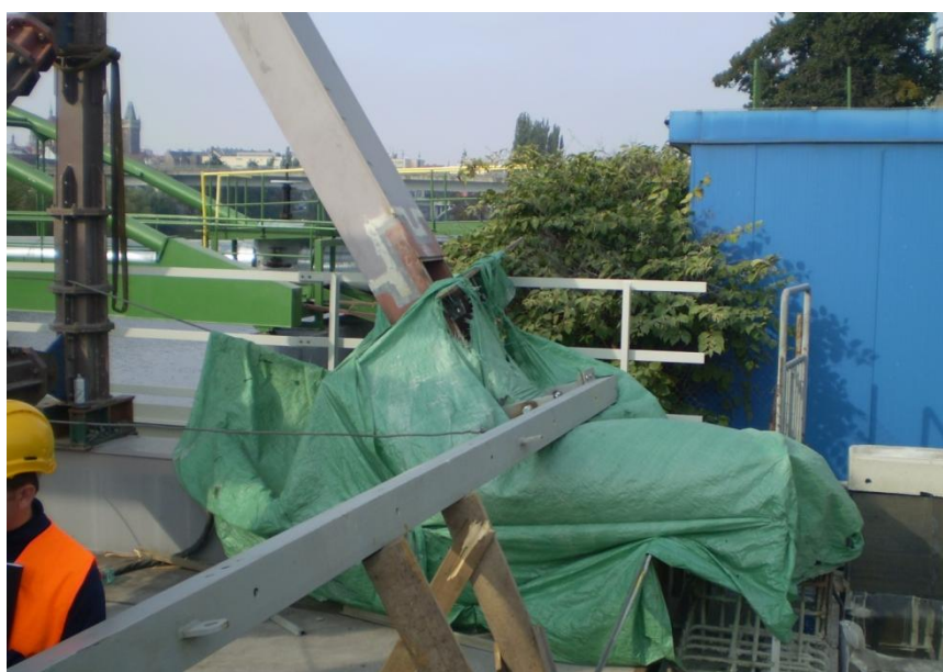
Obr. 25 - Skluznutí krajní traverzy na krytou konstrukci pro svářeče
