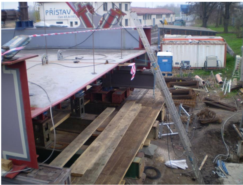
Obr. 16 - Nevhodné zabezpečení okraje mostu bezpečnostní páskou
