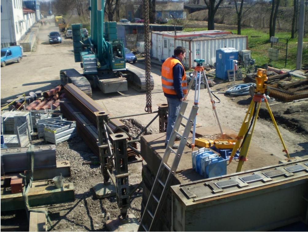
Obr. 27 - Práce ve výšce - nezabezpečení proti pádu osoby
