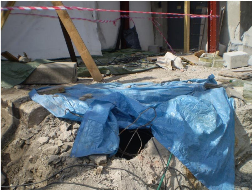
Obr. 19 - Nevhodné zabezpečení výkopu
