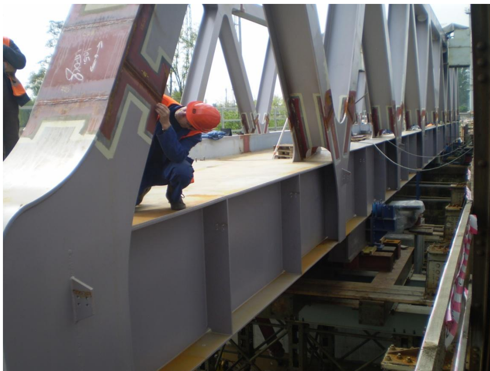
Obr. 30 - Práce ve výšce – Nezabezpečení proti pádu osoby 4
