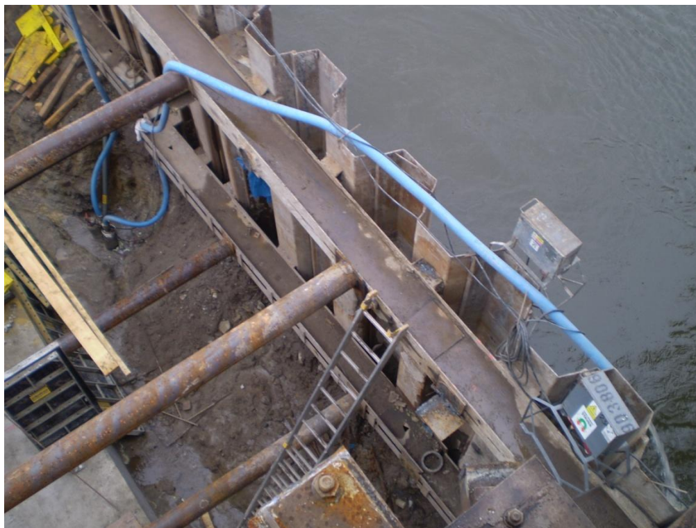
Obr. 31 - Nevhodné použití žebříku 1
