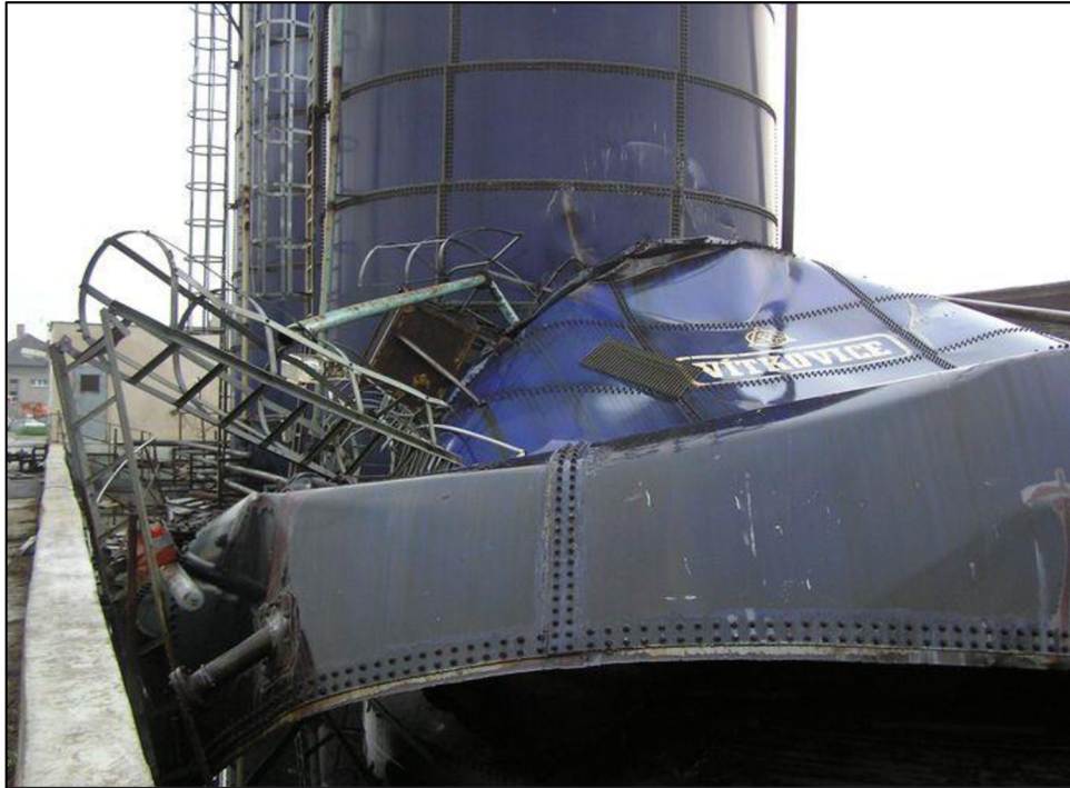
Obrázek č. 7 – Místo nehody, zřízená skladovací věž, Žerůtky [50]
