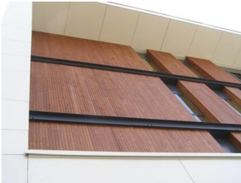
Obrázek 16 Protipožární dřevěné obložení (Woodenha, 17.4.2018)
