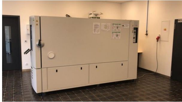
Obr. 18 Klimatizační zařízení (vlastní zdroj)
