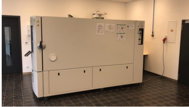
Obr. 18 Klimatizační zařízení (vlastní zdroj)
