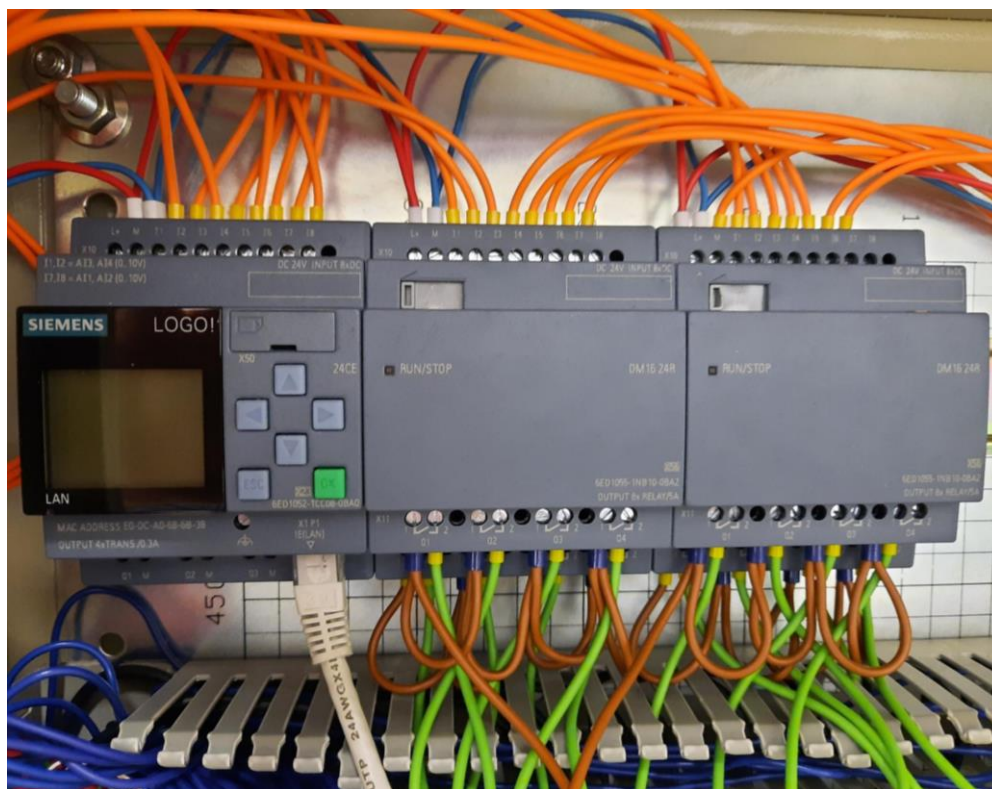
Obr. 27 Zapojení řídicího PLC LOGO! ve skříni elektrického rozvaděče
