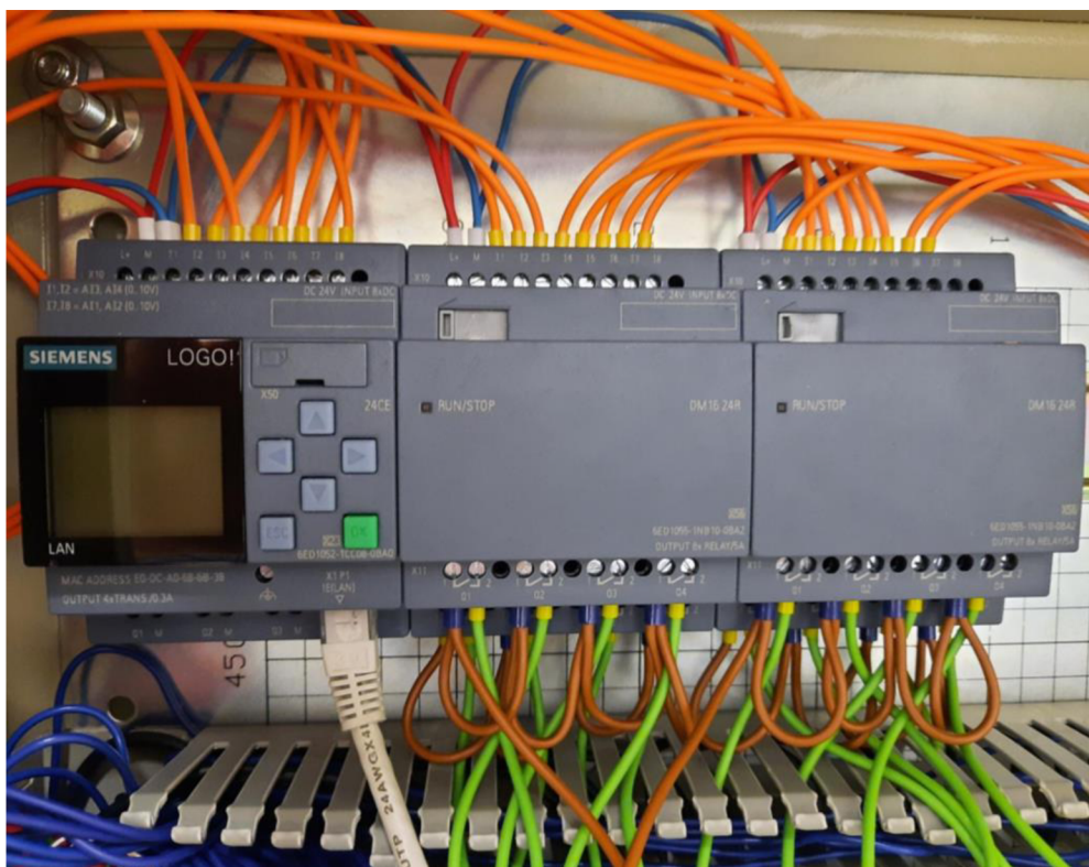
Obr. 27 Zapojení řídicího PLC LOGO! ve skříní elektrického rozvaděče
