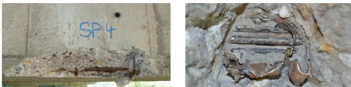
Obr. 7-1: Fotodokumentace zkoumání konstrukce na případnou korozi výztuže betonářské (vlevo) a výztuže předpínací (vpravo)
