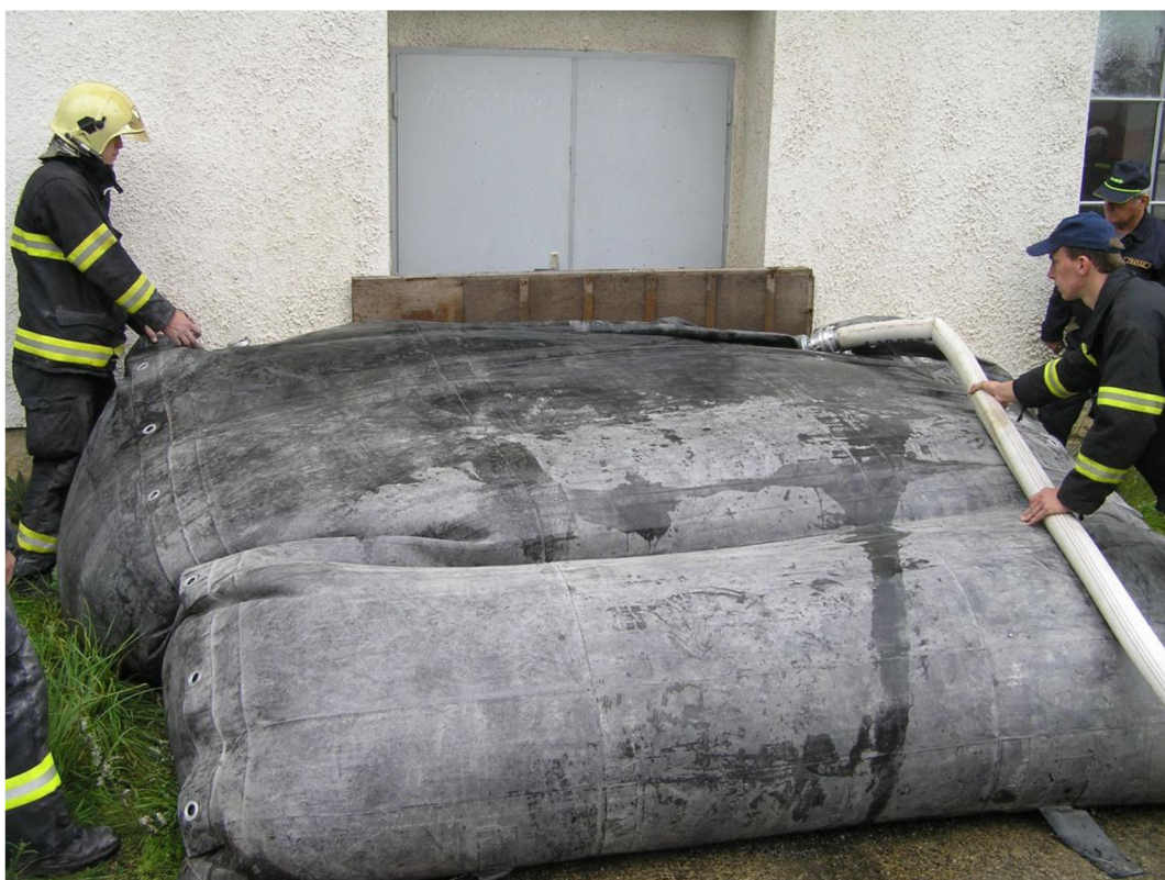
Obrázek č. 9 – zabezpečení objektu pomocí protipovodňové stěny
