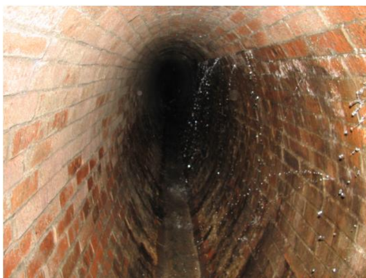
Obr. 21: Pohled do špatně provedené kanalizační stoky (Lesy hl. m. Prahy, ©2024)
