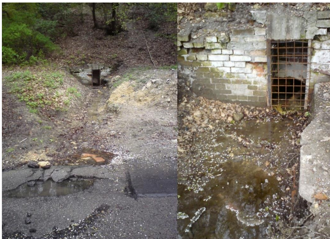
Obr. 37: Únik vody z vodojemu v roce 2015
