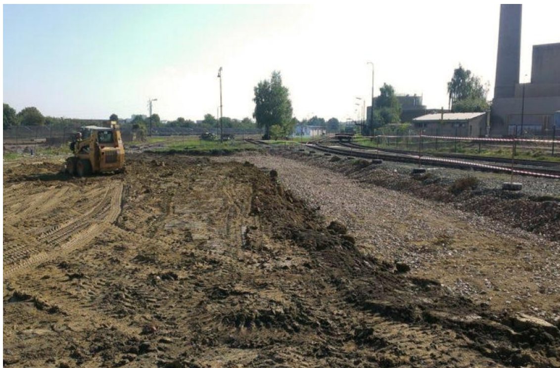
Fotografie č. 10: Oblast T2 „elektrodílny“ – zásyp sanačního výkopu, hutnění, příprava podloží pro obnovu žel. vlečky
