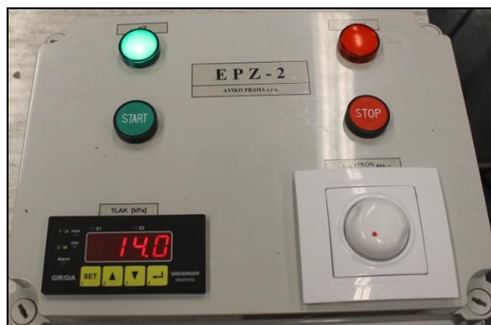
Obrázek 32 Elektrické přečerpávací zařízení EPZ – 2.
